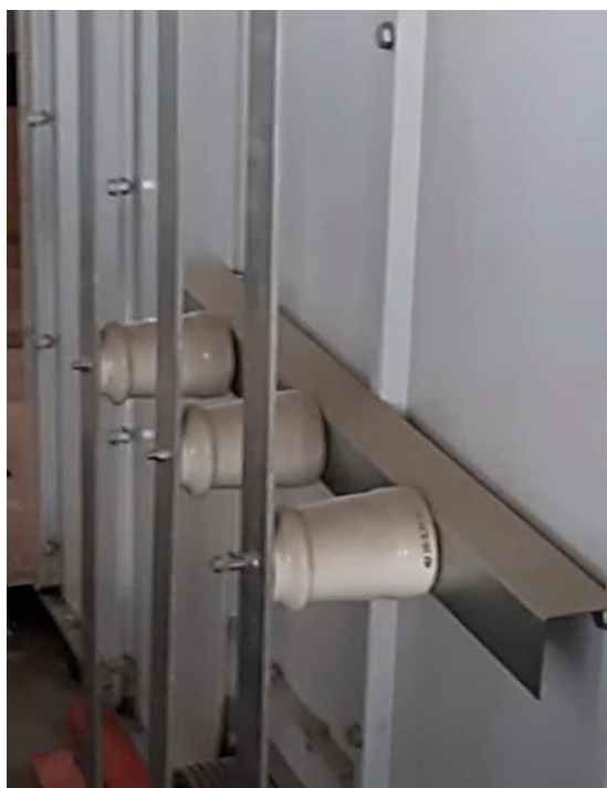
Рисунок 1 – Забруднення ізоляторів ВН КТП 10/0,4 кВ трансформаторного відсіку
